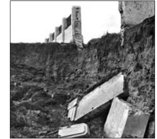
Обрушение изгороди Беседки-памятника И. А. Гончарову. 1959 г. УKM 35901
